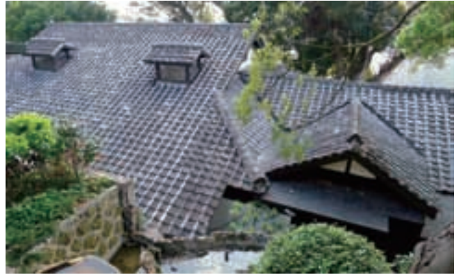
美しい瓦屋根が南国の日差しに照らされている。高台に位置しているためか、真夏でも暑さ知らずだ。
