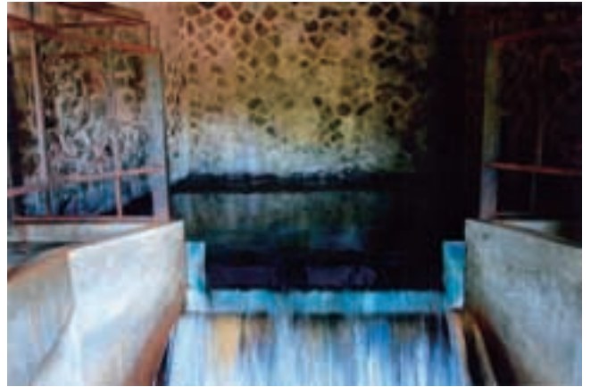
この水道設備が使用されたのは 1932（昭和 7）年からだった。それ以来、台北市民の水瓶として人々の暮らしを支えてきた。
