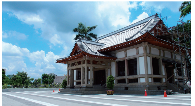
写真25 旗山武徳殿。武徳殿は日本統治時代、ある程度の規模の都市であれば、どこでも設けられていた。現在もいくつかの武徳殿が往年の姿を保っている。
