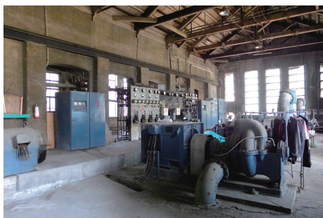
写真20 ポンプ室の様子。現在も高雄市民の水瓶として機能している。
