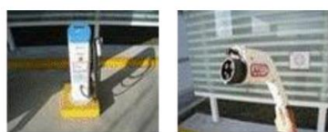
図表 3-10 充電ステーションの設置
