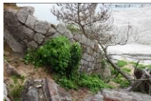
坍毀的構造設施 1
