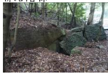
坍毀的砲側庫
