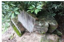
坍毀的構造設施 3
